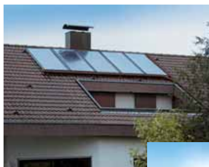
Capteurs installés en toiture
